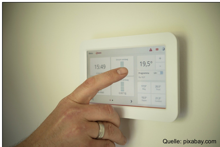
Abb. 7: Steuerung einer smarten Klimaanlage
